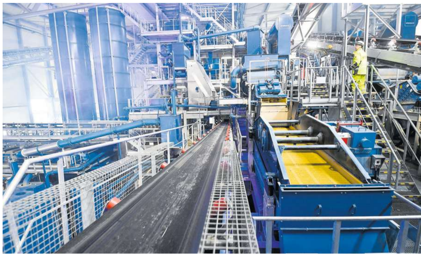
Blick in die neue Aufbereitungsanlage der RCO Recycling Center Ostschweiz AG.
