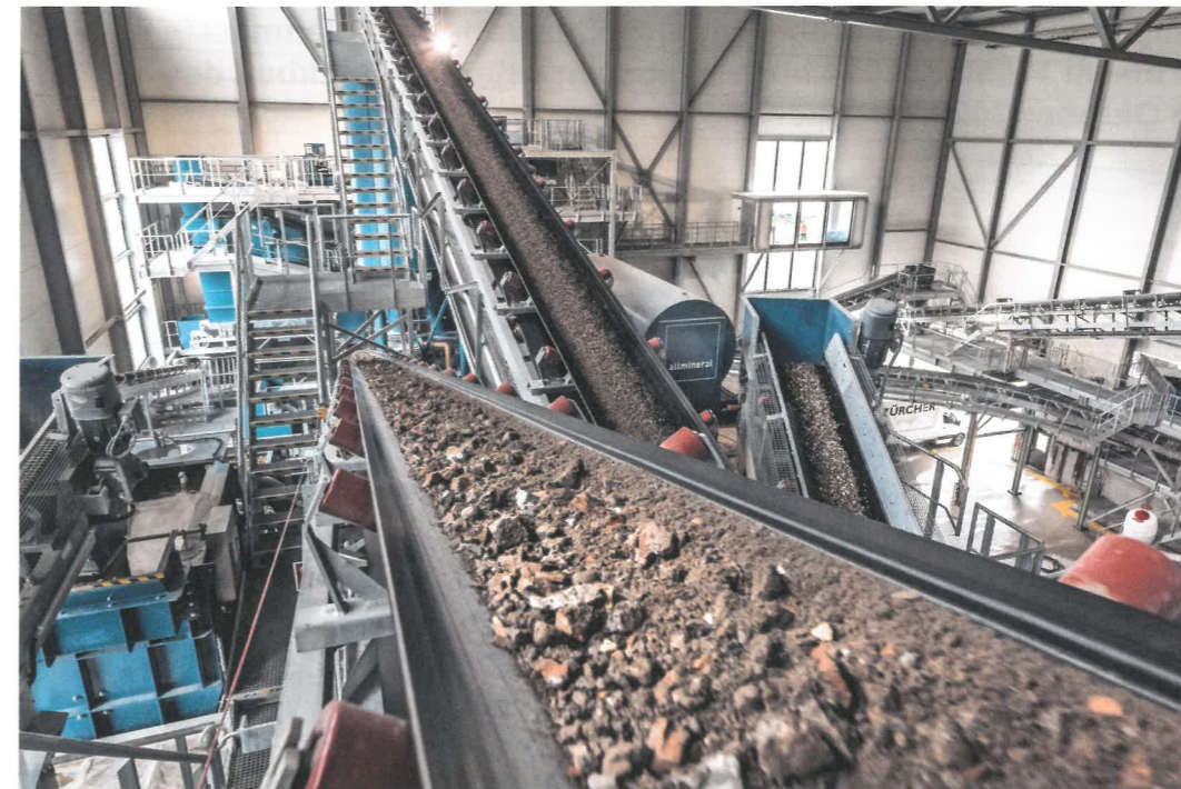
Die Anlage bereitet Rückbaumaterialien wie Misch- und Betonabbruch sowie belastete Aushubmaterialien auf.
